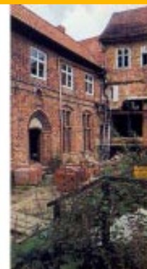
Foto in alto a destra Le opere di restauro richiedono un lavoro coordinato fra specialisti di storia delle costruzioni e tecnici delle opere murarie. Keller
