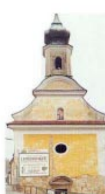
Foto in alto al centro Un restauro durevole può ragionevolmente avvenire solo dopo il risanamento delle fondazioni.
