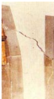
Foto in alto a sinistra Crepe oblique indicano cedimenti differenziali delle fondazioni. Crepe verticali ed orizzontali testimoniano un difetto costruttivo.
