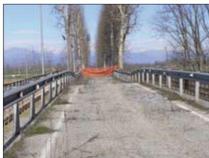
Il cedimento ben visibile sull'impalcato
