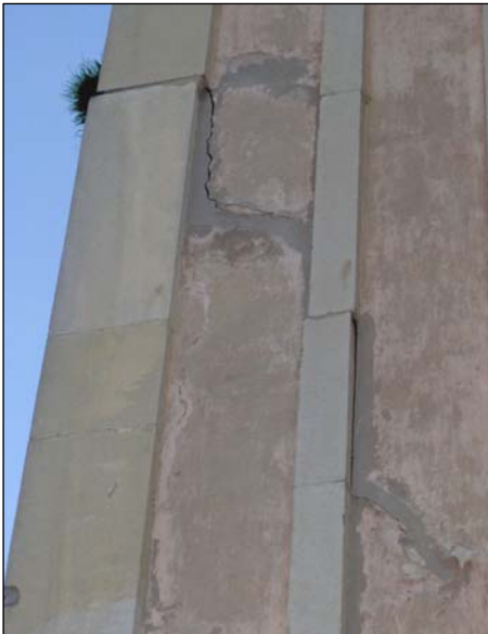
Fessurazioni (spigolo, facciata principale)
